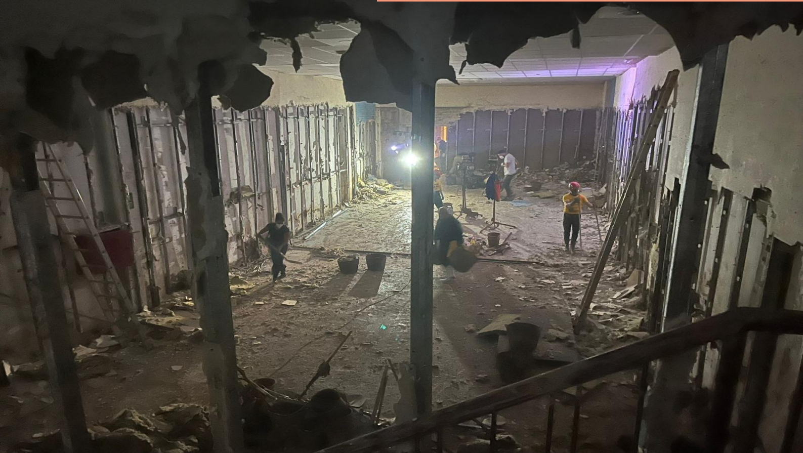
Daños en la Unión Musical de Paiporta
